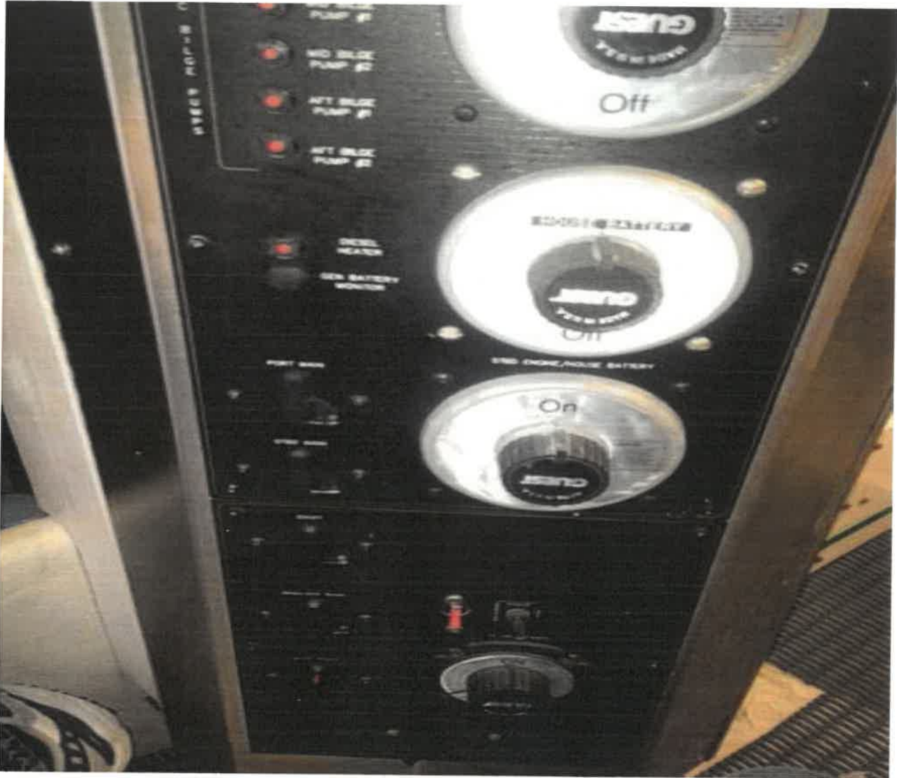
12-volt panel 12-volt breaker
